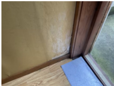
Fukt/saltutslag på vegg ved kjellerdør.
