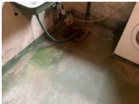
Det er ingen membraner i våtsoner. Salt/kalkutslag på gulv og vegger.
