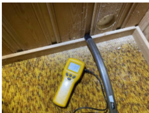
Resultat av fuktmåling viser 19% i panel.
