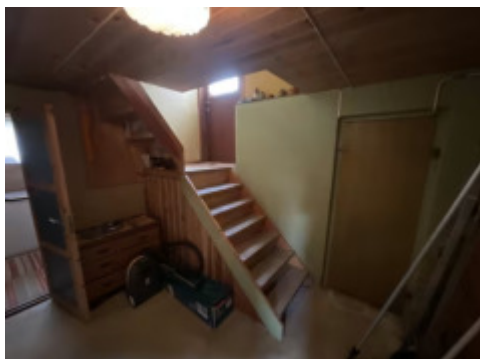
Kjellertrapp mangler rekkverk. Lav høyde i kjellertrapp.
