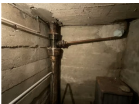
Innvendige avløpsrør fra byggeår har nådd en høy alder
