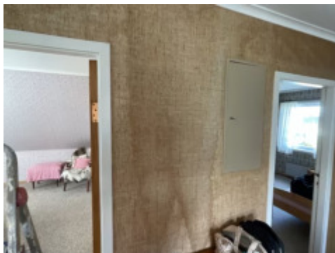
Registrert vannmerker på vegg i kott og på vegg i gang 2 etg.
