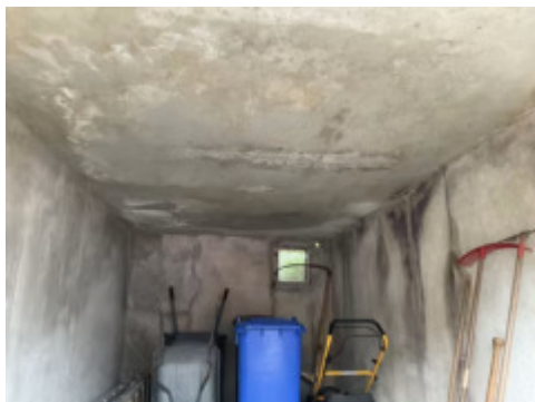
Saltutslag i tak, vegg og gulv.
