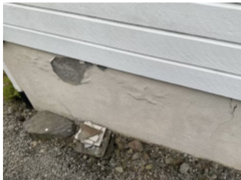
Enkelte riss/sprekker og stedvis noe avskalling av betong på grunnmur.
