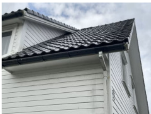
Takrenner har punktvis lekkasjer.
