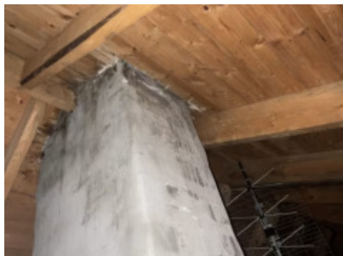
Fukt/saltutslag på pipe loft, dette tyder på at pipen transporterer fukt.
