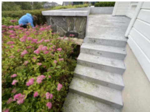
Trapp til terrasse mangler rekkverk.
