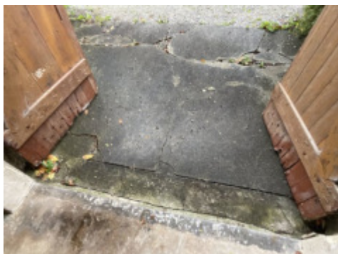
Sprekker i platting utenfor dører.
