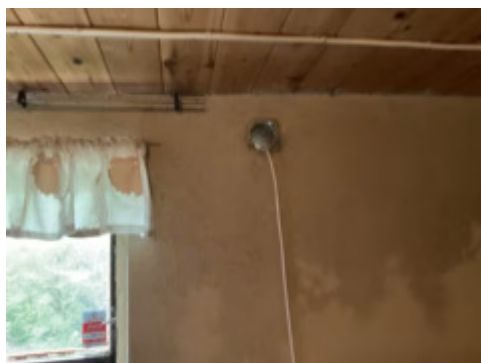
Rommet har kun naturlig avtrekk.
