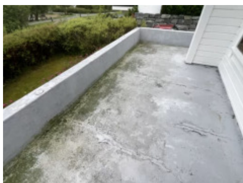
Riss/sprekker i dekke og rekkverk. Konstruksjonen har symptom på skader som tilsier behov for tiltak. Rekkverk på terrasse er for lavt.
