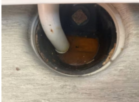
Belegg går ikke ned bak klemring i sluk.
