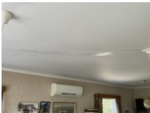
Sprekk i pappet tak i stue.
