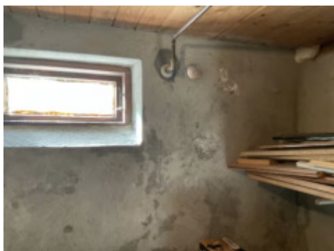
Det registreres salt/kalkutslag på innvendig grunnmursflater
