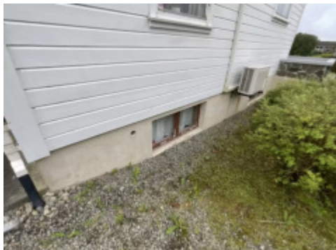
Det er ikke etablert grunnmursplast.
