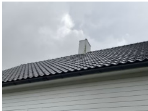
Det er rust i beslag rundt pipa.
