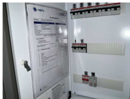
Automatsikringer i sikringskap plassert i bod.
