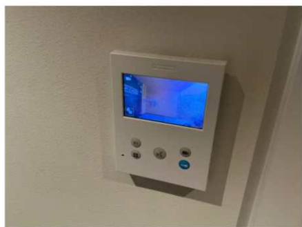
Dørcalling med monitor som er plassert i gang.
