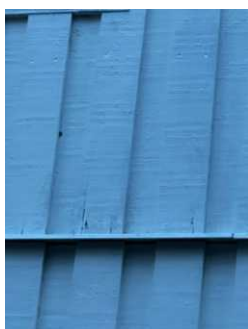
Eksempel på noe sprekker og påbegynnende råte.
