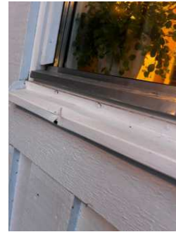
Eksempel på skadet beslag og innfesting.
