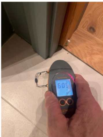
Indikasjon på fukt under flis ved terskel.
