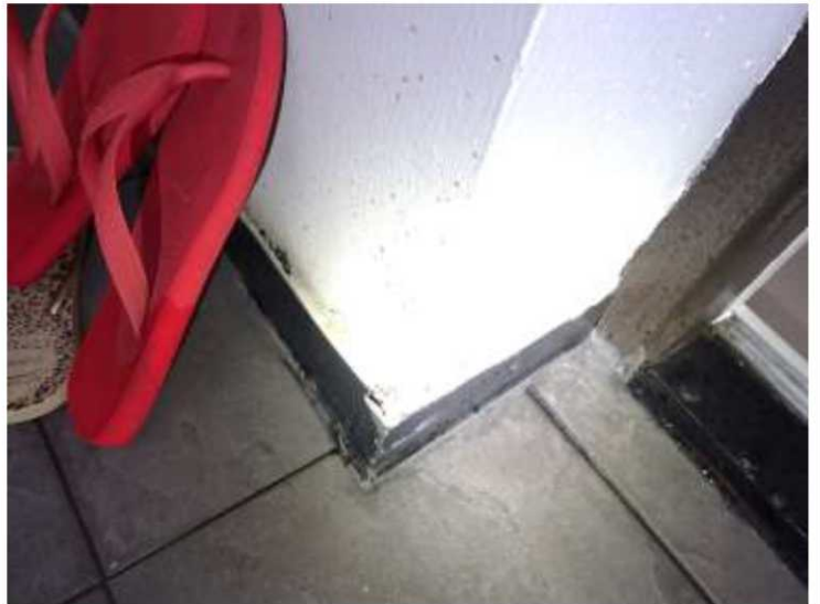
Beslag og elastiske fuger ved skyvedør på terrassen i 2. etg.
