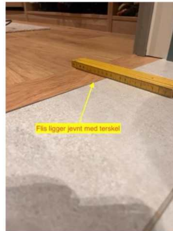
Ingen oppkant på membran ved terskel.
