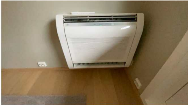
Varmepumpe i stue fra 2024.
