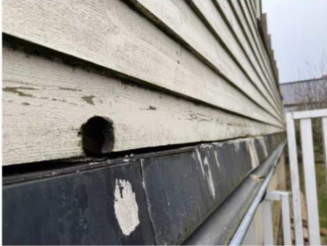
Nederste kleddningsbord på balkongen mot nabo mangler dryppkant
