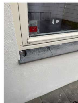
Begynnelse til råte i ett vindu i bod.
