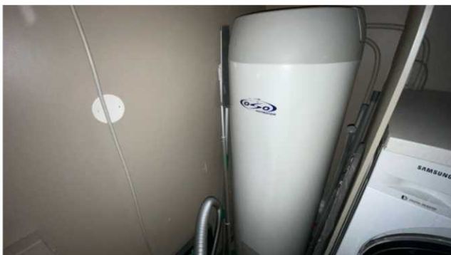
Varmtvannsbereider på 300 liter fra 2007 med stoppekrane.
