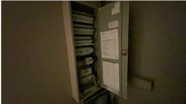
Automatsikringer i el skap fra 2004.
