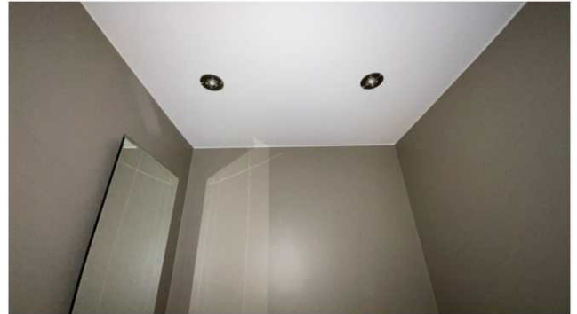
Det mangler avtrekk i rommet.
