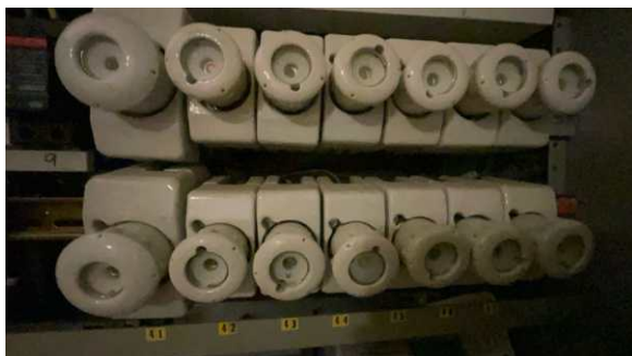
Bilde: Sikringer for gjeldende leilighet.
