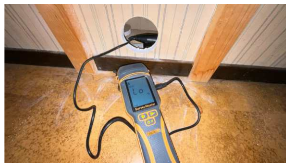
Bilde: Fuktmåling viser tørt, måleverdi ikke påvisbar.
