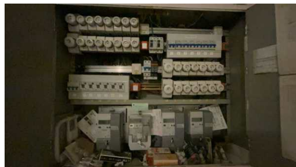
Bilde: Felles sikringsskap for leiligheter er plassert i felles trappegang (underetasje).
