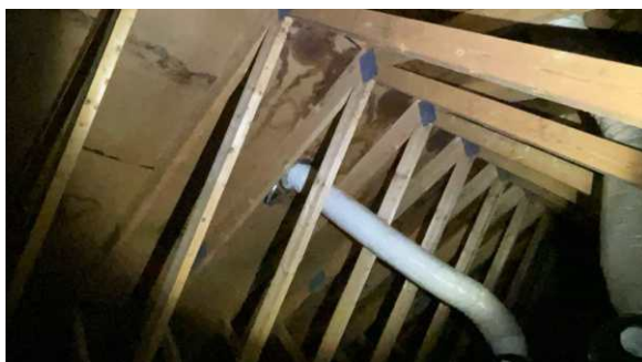
Bilde: Fuktskjolder i takkonstruksjonen.
