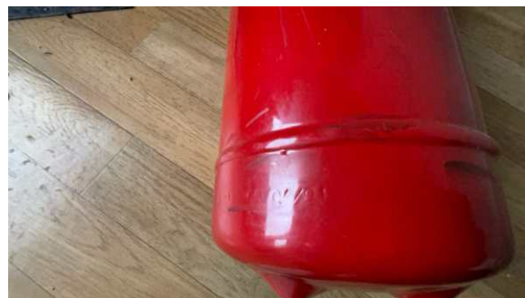
Bilde: Brannslukker er datert -91 og er for gammelt. Det ble ikke registrert røykvarsler i leiligheten ved befaring.
