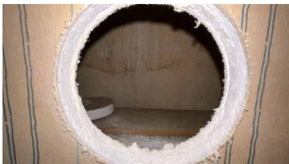
Bilde: Hulltaking er foretatt uten å påvise unormale forhold.
