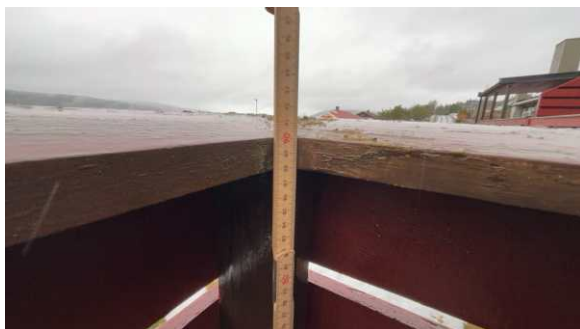
Bilde: Rekkverkshøyde er ca 91 cm og er under dagens krav til rekkverk.
