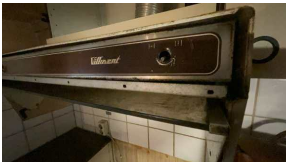
Bilder: Avvik med avtrekk.
