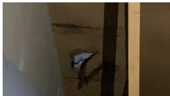
Bilde: Skade i takkonstruksjonen.
