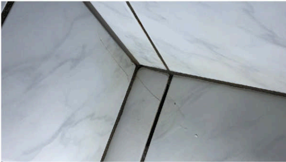
Sprekker gulv og vegg i dusj
