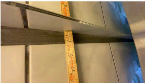
Ikke fagmessig utført flisarbeid.
