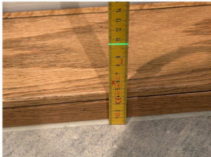
Fallforhold - ca. 105 mm overkant gulv ved terskel
