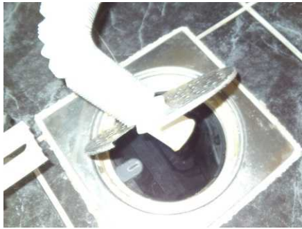
Sluk under dusjkabinett.
