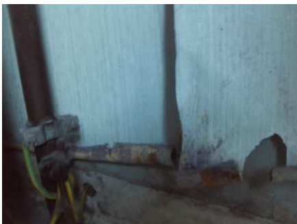
Tapet er skadet og løsnet flere plasser.
