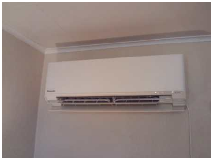
Varmepumpe i stue.
