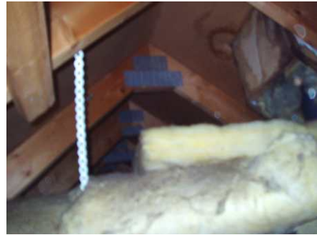
Noen mindre fukt/kondensmerker ved takgjennomføring.
