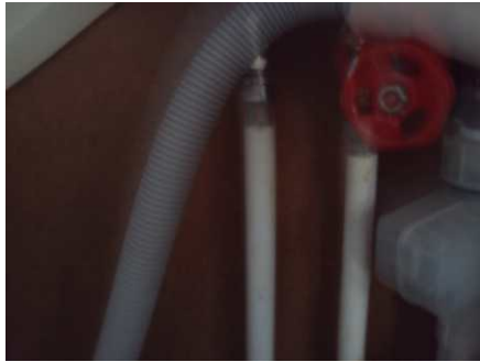
Kobberrør i kjøkkenbenken.
