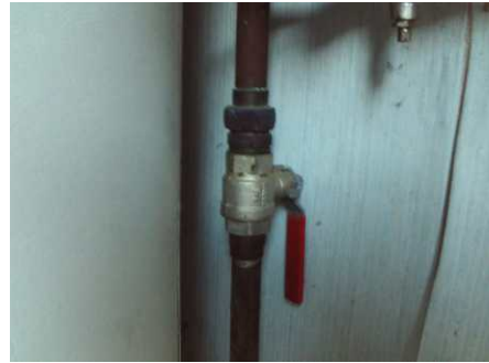
Innvendig stoppekran på vaskerommet.
