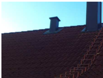
Pipe og luftehatt er helbeslått over tak.
