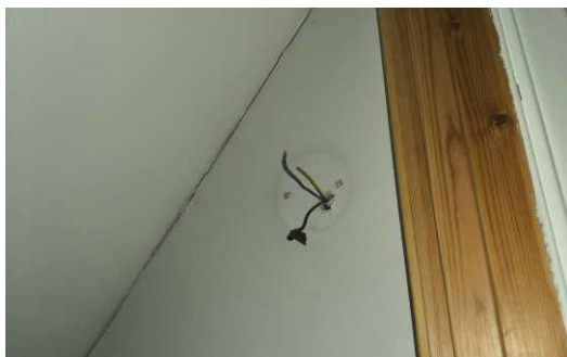
Løse ledning på kott på loft
