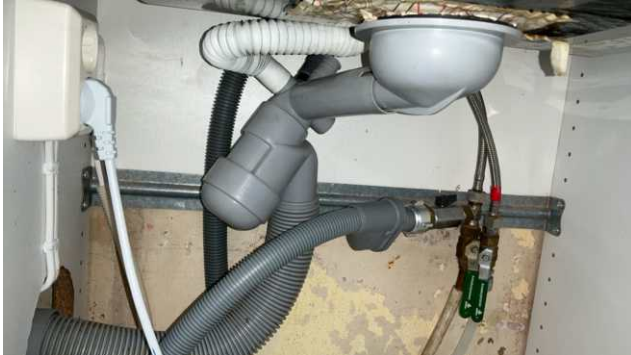
Avløp vask kjøkken
