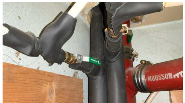
Stoppekraner bad bak luke i tak.
