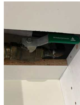
Hovedstoppekran i luke i kjøkkeninnredning
