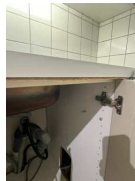
Oppsvulming av laminat grunnet vannsøl over tid
