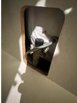
Varmtvannsbereder innbygget i kjøkkeninnredning.
