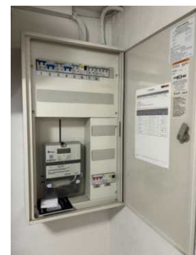
El. skap med aut. sikringer i garderobeskap
