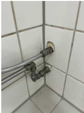
Rørgjennomføring i dusjvegg uten tettesjikt/mansjett
