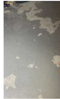
Noe avflassing på malte betonggulv.
