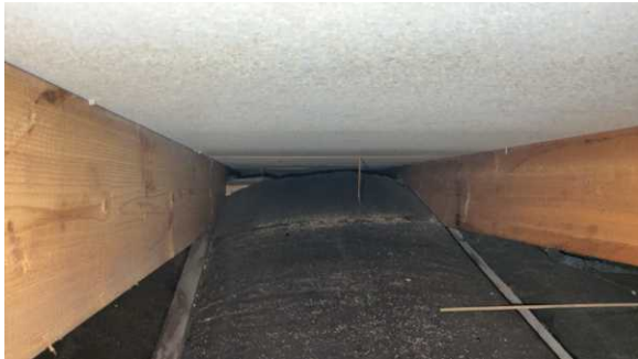
Begrenset ventilering fra loft til tilbygg.
