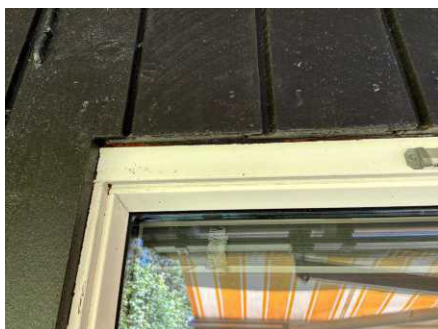
Manglende utvendig tetting.
