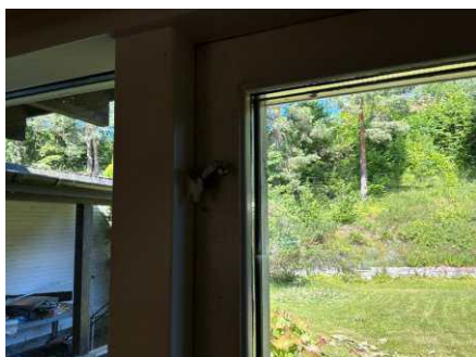
Eksempel på defekte vindushasper.
