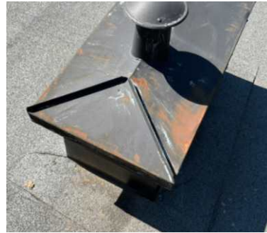
Eksempel på rustdannelser.
