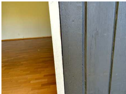
Manglende utvendig tetting.
