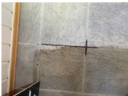
Misfarging i flisefuger.
