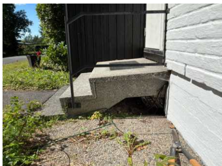
Trapp med skjevheter.
