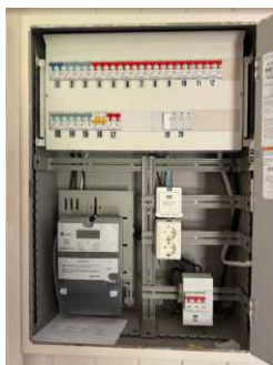
Sikringsskap med automatsikringer
