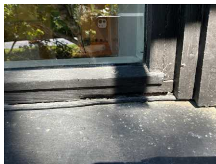
Avvik i beslag ved kjøkken.
