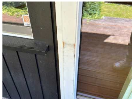
Eksempel på mindre skader.
