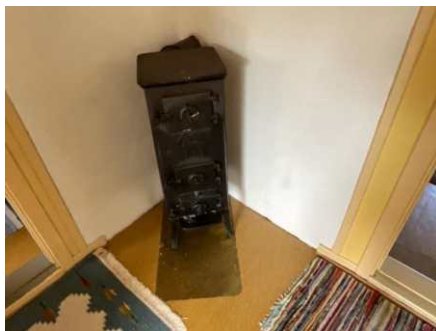
Montert ovn i soverom.
