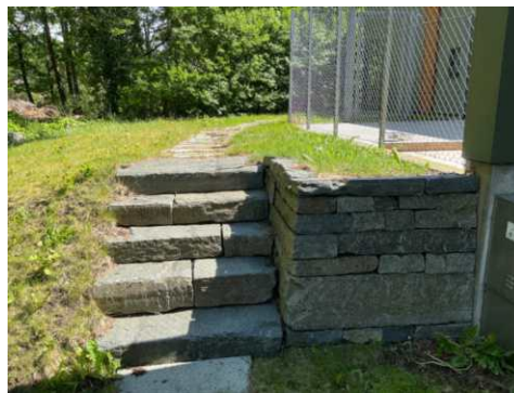
Manglende rekkverk/sikring på utvendig mur
