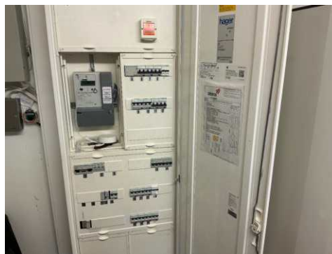
Sikringsskap i teknisk rom
