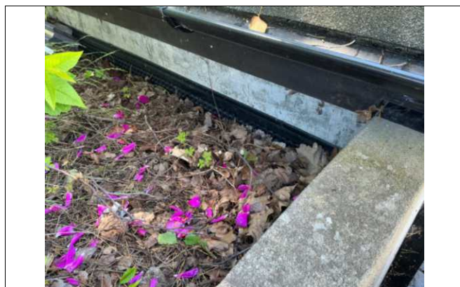
Synlig grunnmursplast registrert på tilbakefylt del. Hovedsakelig overbygd/skjult løsning
