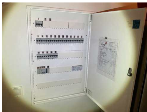
Sikringsskap i hovedhus
