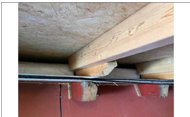
Tegn til luftespalte registrert ved gesims
