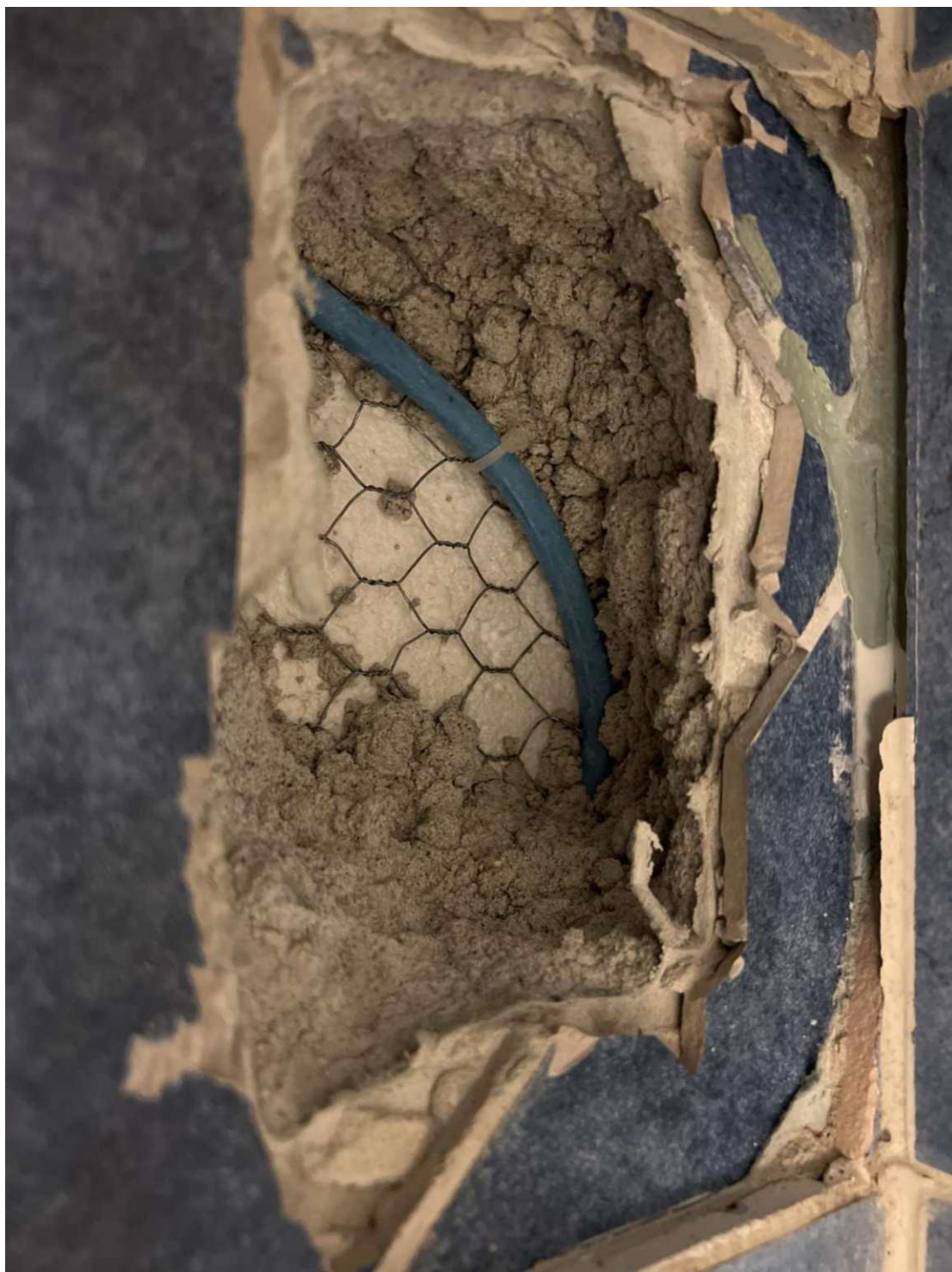
Skadested hugget opp
