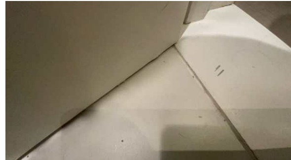
Luftespalte under dørbladet.
