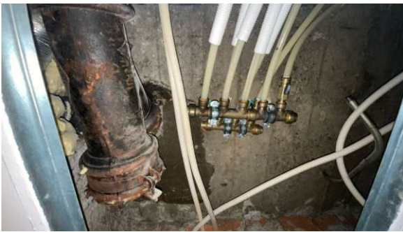
Samlestokk i kobber for vannrør er montert over himling på baderommet.
