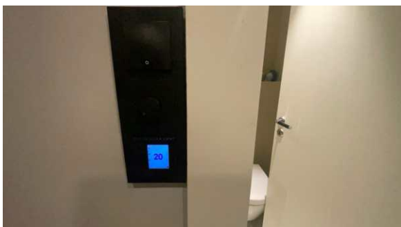
Termostatbryter til varmekabler.
