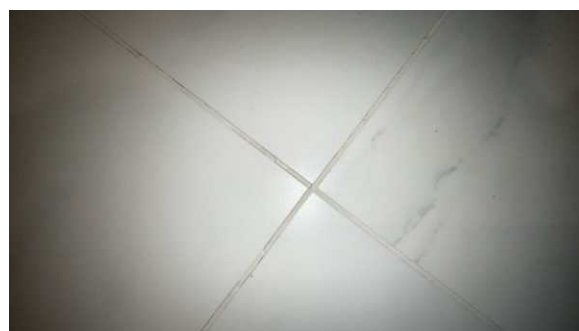
Bom i glvflis. Riss i sementfuger mellom gulvflisene.
