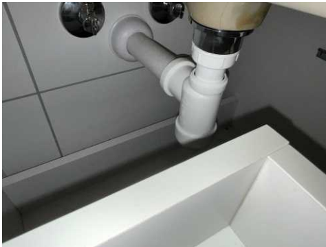
Røropplegg under håndvask, bad.
