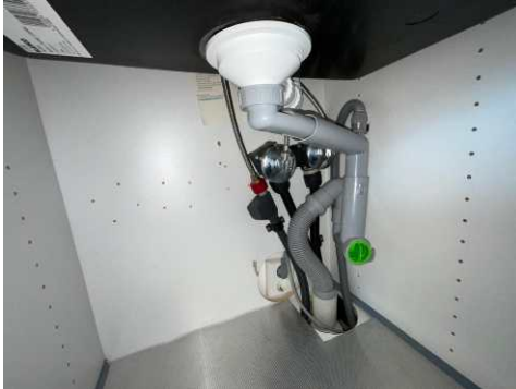
Røropplegg under kjøkkenskiv.
