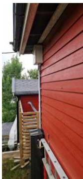
Misfarging i undertak i takutstikk.
