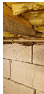
Avskallinger og setninger i gassbetong.
