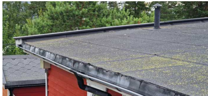
Åpne skjøter/mosegrodd tekking.
