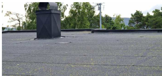
Åpne skjøter/mosegrodd tekking.
