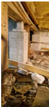
Isolasjon er ikke tildekket. Provisorisk understøttelse av bjelkelag.
