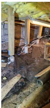
Skjevheter, sprekker og utettheter i grunnmur.
