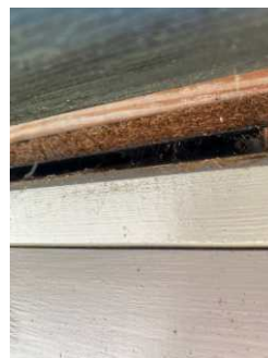
Manglende musesperre på tilbygg.
