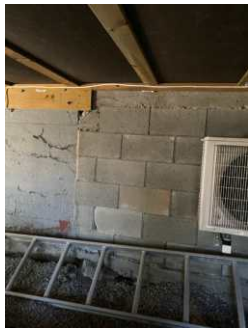
Skille mellom gammel og ny mur.
