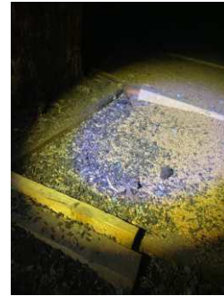
Avføring fra smågnagere på kaldtloft.
