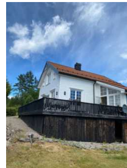
Mangler et beslag ned i takrenne på hovedtak inn mot tilbygget.
