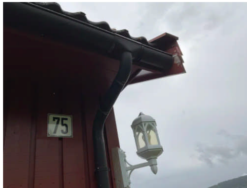
synlige tegn til utettheter i overganger.
