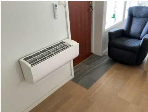
Varmepumpe i underetasje
