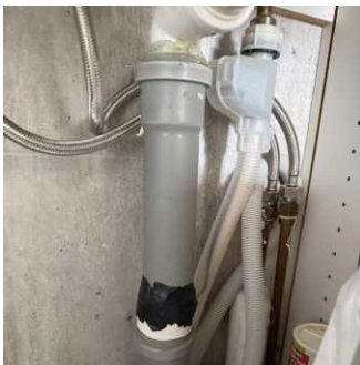
Under vasken på kjøkken i underetasjen.
