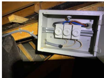
Inntaksikringer på loft.
