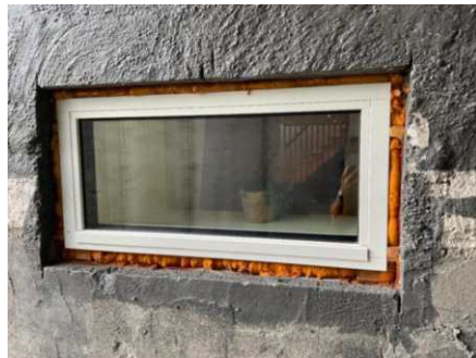
Uferdig omramming vindu.
