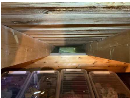
Lufting blokkert av ventilasjon.
