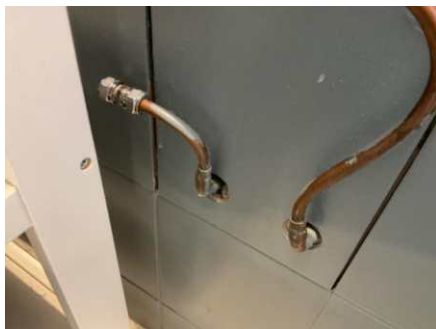
Ingen tettelsninger på rørgjennomføringer.
