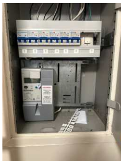
Sikringskap for leilighet er lokalisert i gang.
