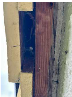
Manglende musebånd i nedre kant av bordkledning.
