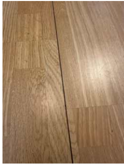
Glippe i parkettgulv på stue 2.etasje.
