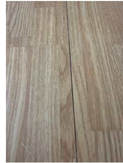
Glippe i laminatgulv på stue 1.etasje.
