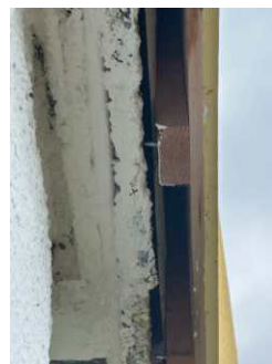
Manglende musebånd i nedre kant av bordkledning.
