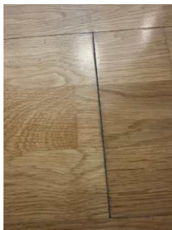
Glippe i tverrskjøt på stue 2.etasje.
