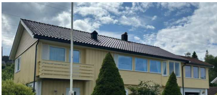
Manglende snøfanger på takflater.
