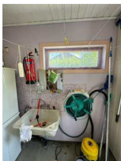
Utslagsvask og opplegg for vaskemaskin mot øst.
