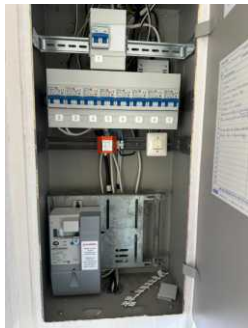
Sikringskap for boligdel lokalisert i gang.
