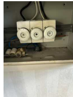
Hovedsikringer er lokalisert i gang.
