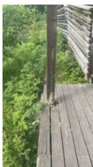
Bevegelser/synk i fundament. Eier har skiftet oppsprekte bord.
