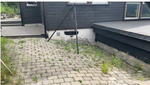
Fall inn mot bygning.
