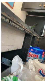
Synlig mdf med avskallet overflatebehandling.
