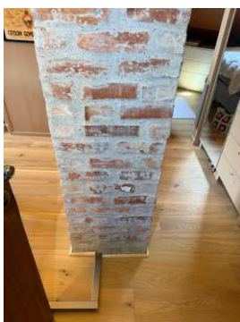
Pipeløp i boligen (ikke i bruk iflg.tidligere opplysninger)
