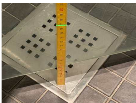
Fallforhold ca. 167 mm topp slukrist i dusjsone
