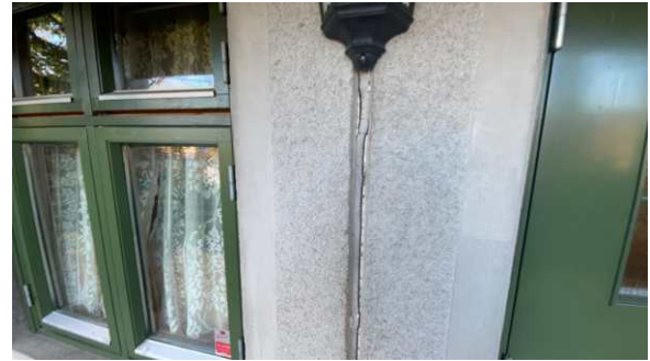
Fuge sprekker opp.
