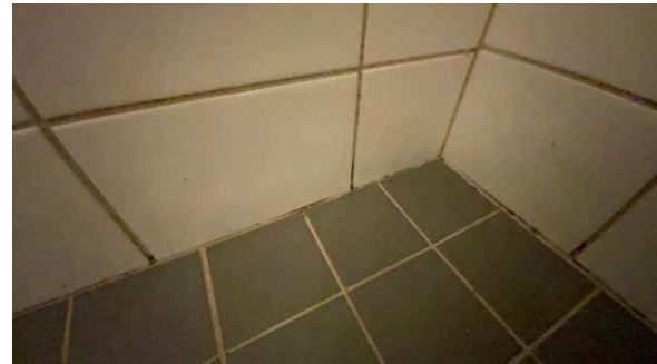
Riss i fliser.
