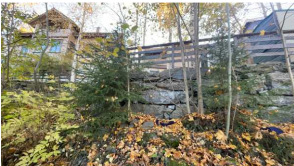
Åpninger i rekkverk er mer enn 10 cm.
