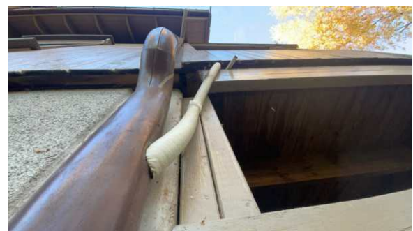
ingen synlig musesperre i hjørnekasser.
