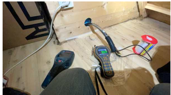
Fuktmåling i bunnsvill mot dusj. Målinger viser 13,3%
