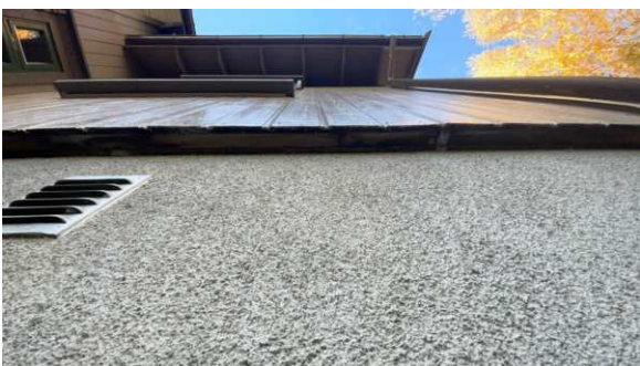
Kledning ikke luftet.
