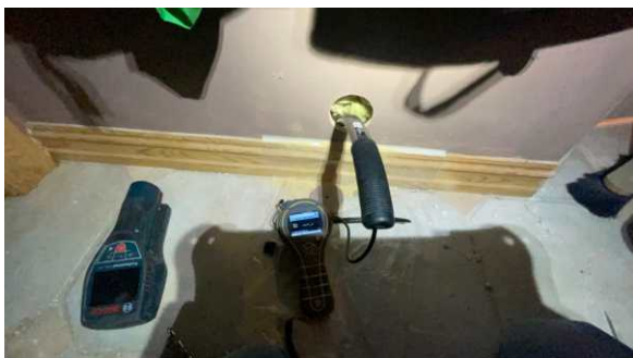
Fuktsøk i bunnsvill mot badet fra gangm/trapp.
