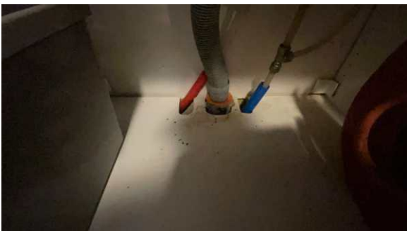
vannrør mangler endettemuffer.
