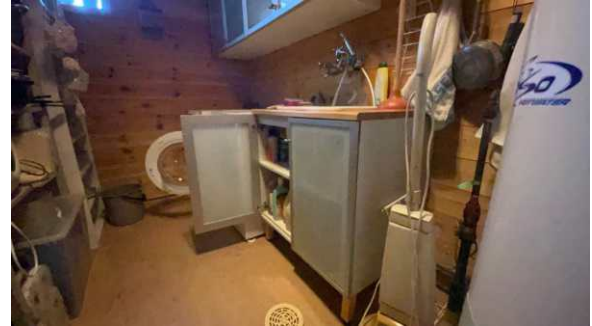
Ingen tettesjikt på vegger i våtesoner.
