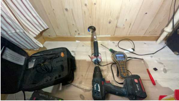
Fuktsøk med pigger i bunnsvill mot våtrom. Måling viser under 7%
