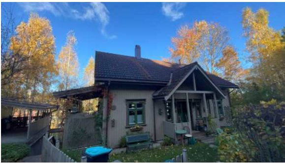
Ingen snøfangere på tak.
