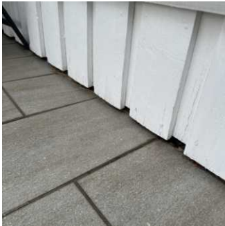
Lite avstand fra kledning og ned til plattning.
