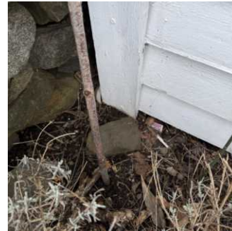
Lite avstand til terreng og råte i hjørnebord.
