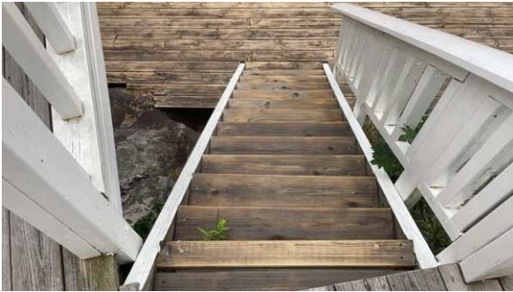
Trapp med kun rekkverk på en side.
