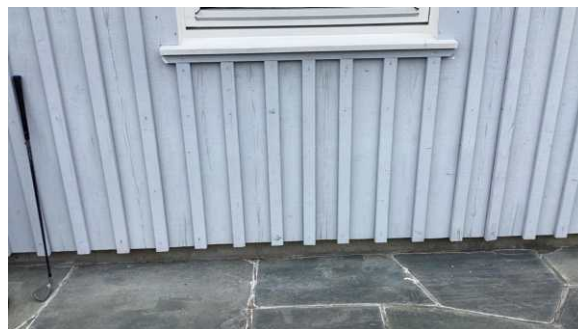
Noe værslitt kledning på sydveggen.
