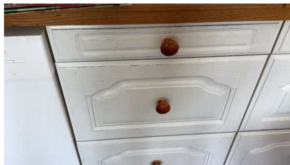
Litt slitasje på innredningen.
