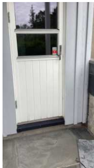
Terrassedør med noe værslitt dørbblad.
