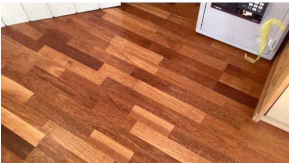
Noe merker i parkettgulvene.
