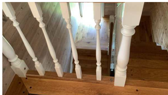
Store mellomrom i spilene på rekkverket.
