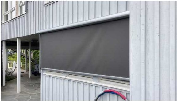
Utvendig screen på flere vinduer.
