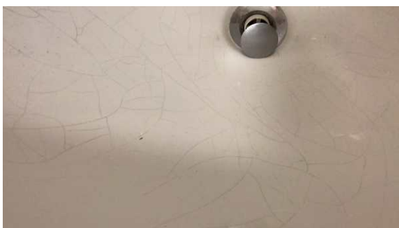
Sprekkdannelse/krakelering i vasken.
