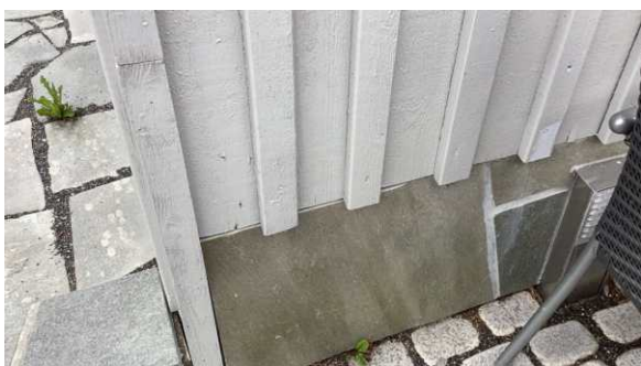
Lite lufting mellom kledning og grunnmur.
