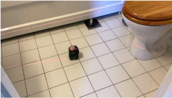
Svakt fall på gulvet.
