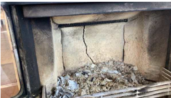
Sprekk i ildsteinen i brennkammeret til klebersteinsovnen.
