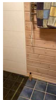
Manglende membran på flere vegger.
