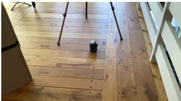
Opp til ca 25 mm skjevhet i 2 etg.
