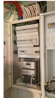
To sikringsskap plassert i underetasjen.
