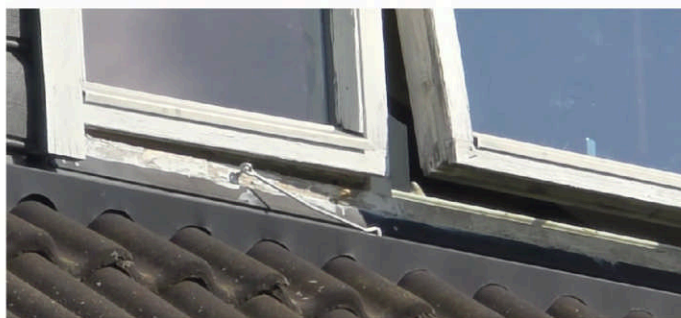
Manglende beslag over vindu
