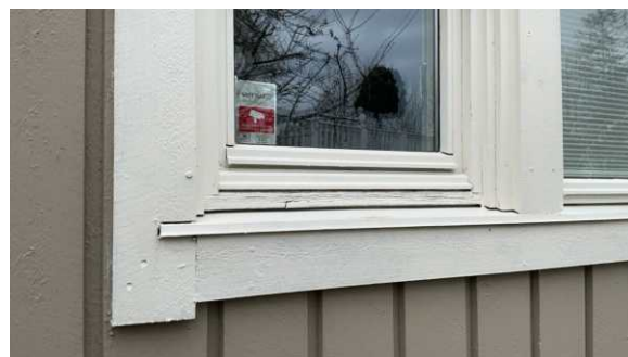
Råte i selve vinduet
