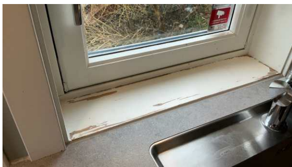
Slitasje på innvendige foringer.
