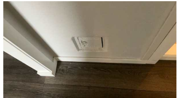
Ikke plate på gulvet under sotluken
