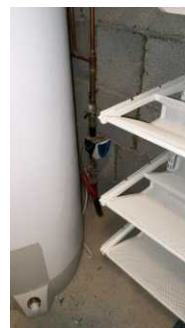
Vannmåler og stoppekran i boden
