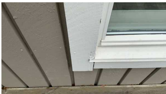
Noe råte i utvendig belistning på de eldste vinduene.
