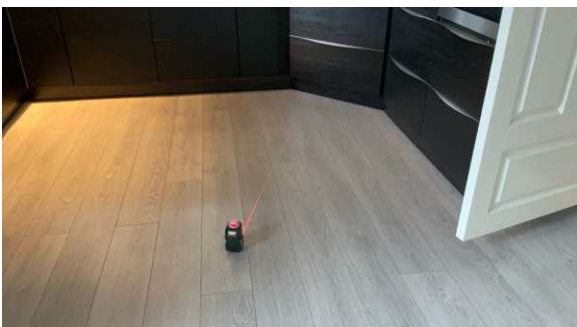
Opp til ca 25 mm skjevhet i gulvet på kjøkkenet.
