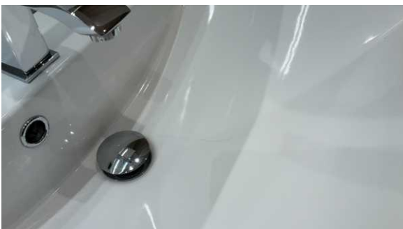
Litt krakelering i vasken.
