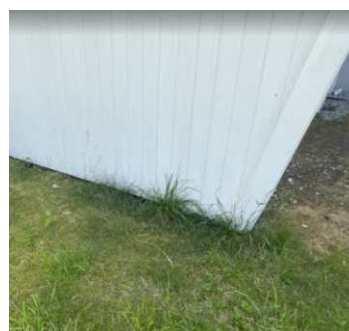
Det er stedvis for lav avstand fra bordkledning til terreng/sprutsone.
