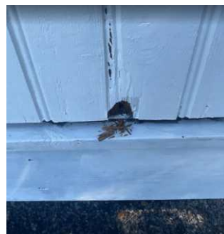
Det er registret noen mindre områder med råteskader (Vinterhage)
