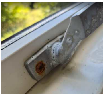
Det er registret rust på enkelte håndtak
