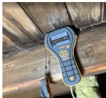
Områder med misfarging i undertaket.
