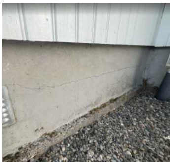
Grunnmuren har sprekkdannelser.
