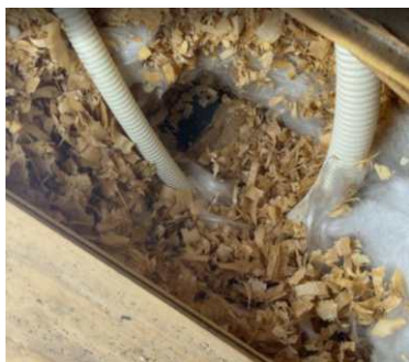
Det ble påvist utettheter rundt gjennomføringer til underliggende etasje.
