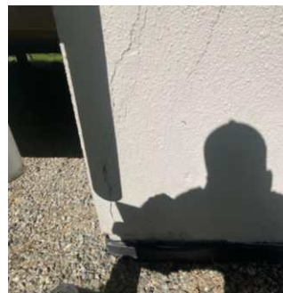
Grunnmuren har sprekkdannelser.
