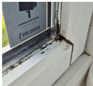
Det er fuktmerker på enkelte innvendige vinduskarmer (tegn på innvendig kondens)
