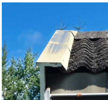
Avlassende lakk/maling er observert på pipebeslag og isbordbeslag.
