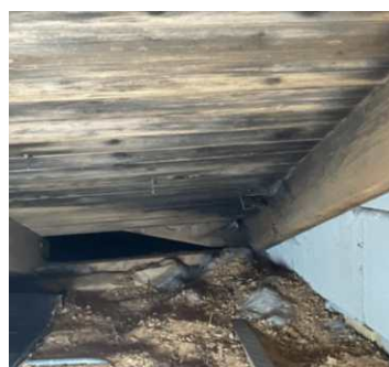
Områder med synlig misfarging i undertaket
