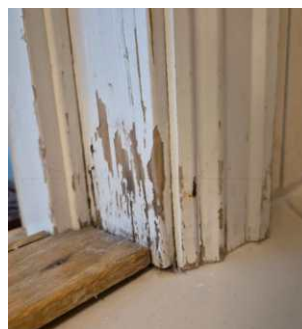
Karm og gerikter på badet har fuktskader.
