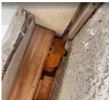
Det er områder i nedre del av kledningen med lite eller ingen lufting
