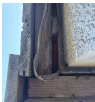
Det er områder i nedre del av kledningen uten synlig musesperre
