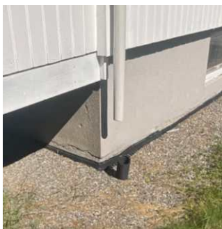
Ikke tilfredsstillende bortledning av takvann
