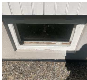
Det er eldre vinduer med koblede glass og høy slitasje
