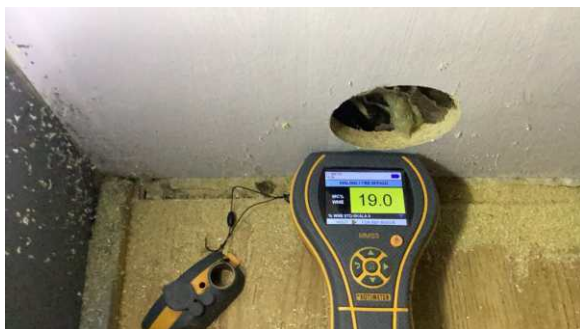
Noe høye fuktverdier i veggplatene mot grunnmuren i underetasjen.
