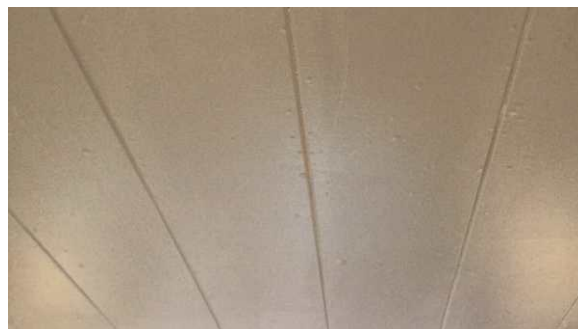
Det har dannet seg bobler i overflatene på mdf-taket.
