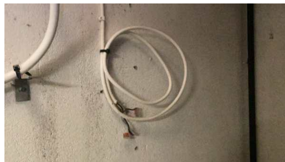
Løst ledning og åpent punkt i boden.
