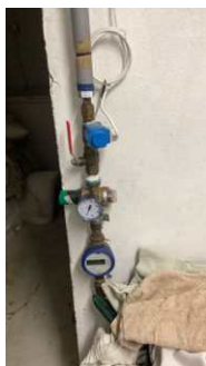
Vannmåler og stoppekran på vaskerommet.
