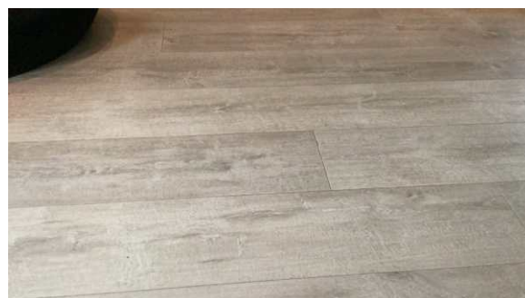
Noen avskalinger i skjøtene på laminatgulvene i 1 etg.
