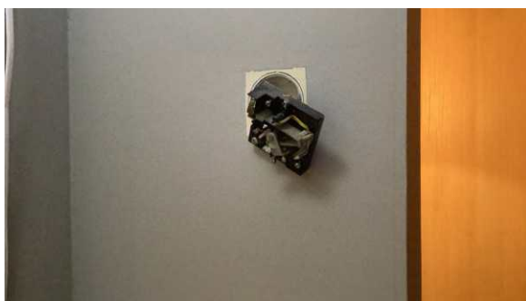
Åpent og løst punkt på soverommet i underetasjen.
