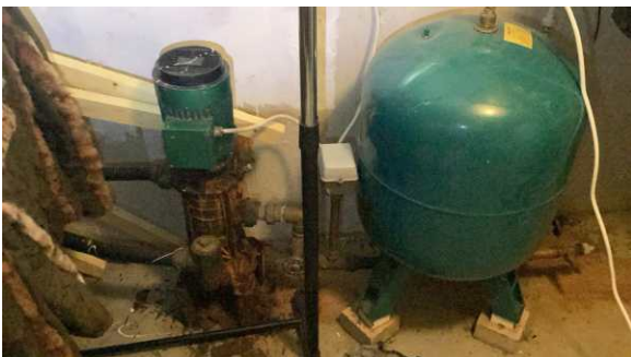
Rustskader på pumpe til brønnvann.
