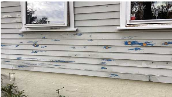
Avskalinger på kledningen.
