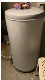
Tanken er plassert på vaskerommet.
