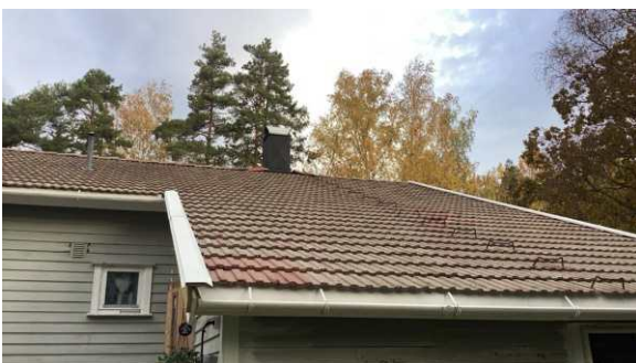
Eldre betongstein på taket.
