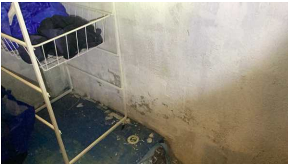
Saltutslag på veggen i kjeller.
