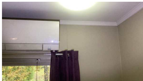
Riss i vegg over vinduet på ene soverommet.
