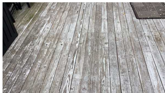
Betydelig slitasje på terrassebordene.
