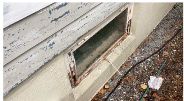
Råte i kjellervindu.
