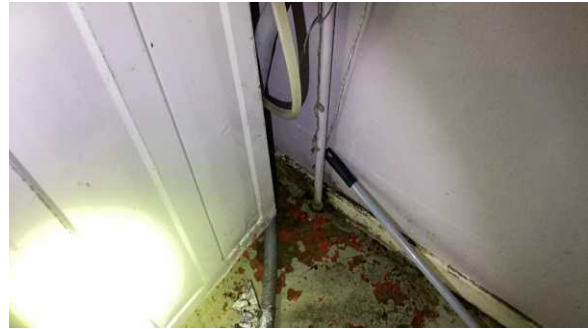
Fukt veggplatene bak vaskemaskinen.
