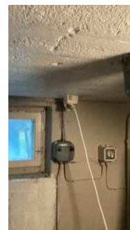
Tanken er tilkoblet strøm via stikkontakt.
