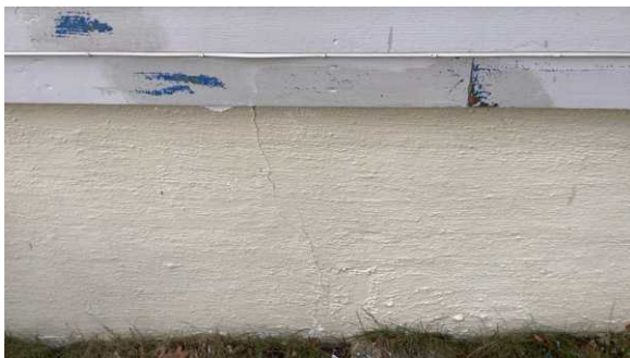
Riss i grunnmuren.
