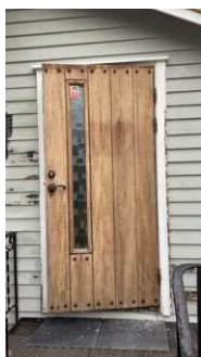
Ytterdøren bærer preg av manglende vedlikehold.
