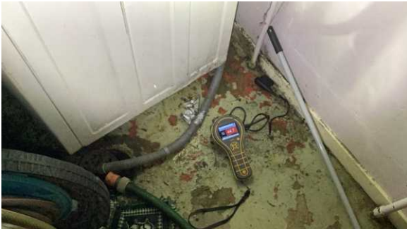
Fullt fuktutslag i veggplatene bak vaskemaskinen
