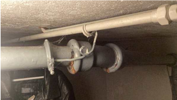
Rust på avløpsrør.
