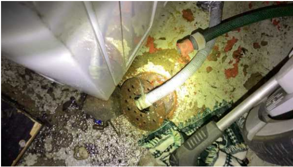
Sluk med rustskader, det er ikke membran på gulv
