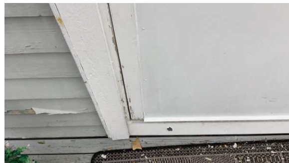
Slitasje på terrassedøren.
