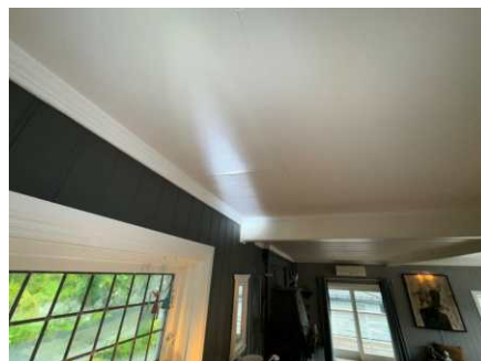
Påvist blemmer/fuktskjolder på takessplater i kjøkken og stue i 1.etg
