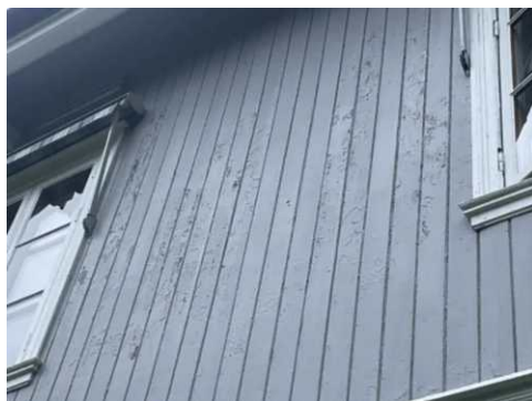
Slitasje/avflakking fra trekledning
