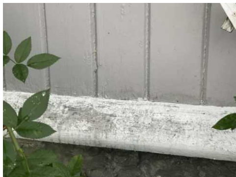
Trekledning avsluttet for nære vannbrett.
