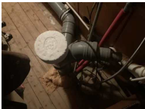
Kloakk avsluttet med durgoventil på loft.
