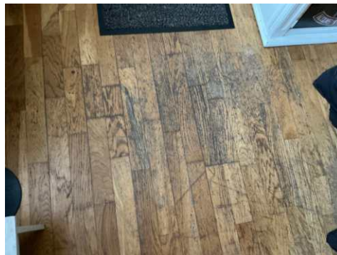
Slitt gulv leilighet høyre.
