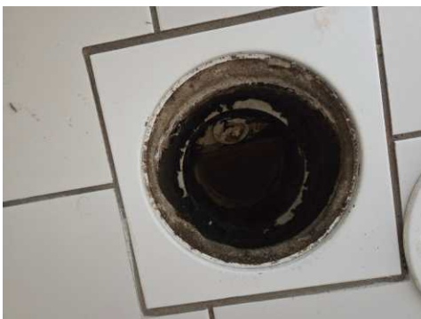
Sluk med membran under påstøp i gulv.
