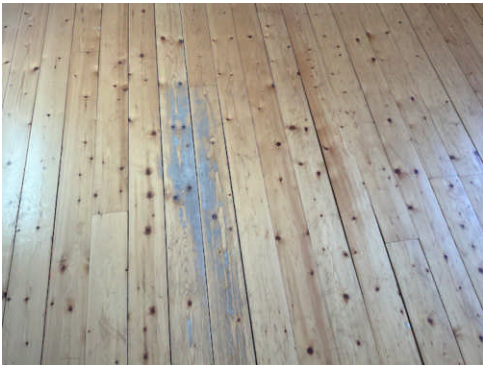
Slitasje på tregulvet
