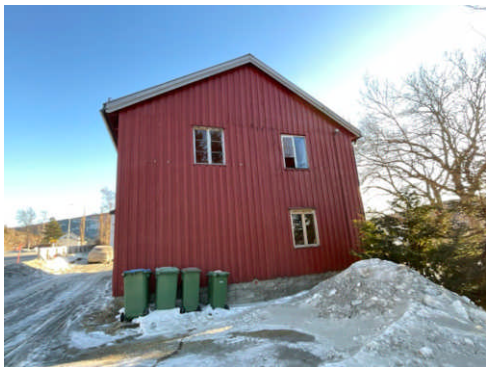
Råteskade i kledning
