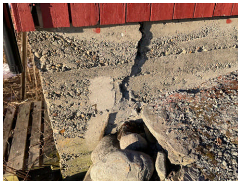
Sprekk på hjørne av grunnmur
