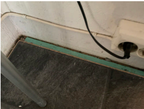
Gulvet ligger ikke inn mot veggen
