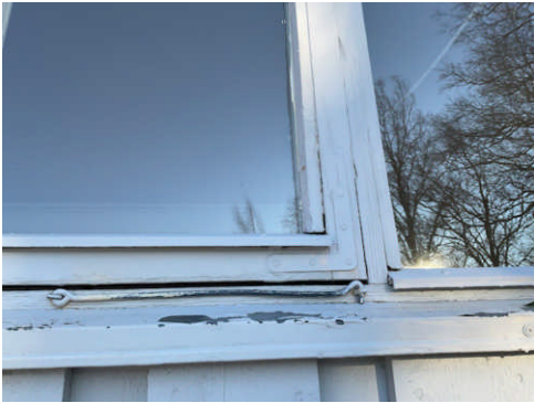
Vinduer med behov for utbedring/skifte
