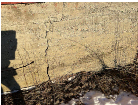
Sprekk på låvens langside
