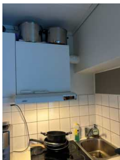
Defekt avtrekksvifte på kjøkken.
