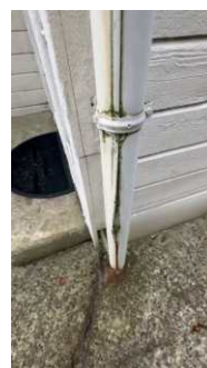
Frostsprengt taknedløp mot nord
