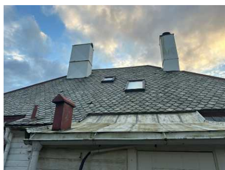
Manglende snøfangere på tak
