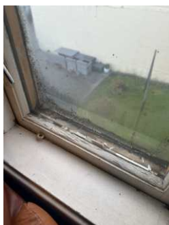
Vindu med innvendig kondensering og råteskader
