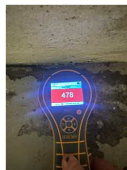
Fuktsøk ved betonggulv med forhøyede verdier.
