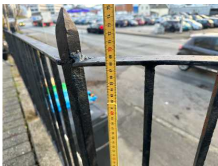
Rekkverk på forstøtningsmur mot sør er målt til 68cm.
