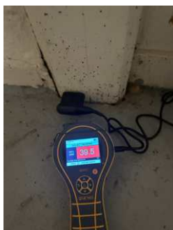
Fuktmåling med pigg ved søyle i tre ved pipe/sotluke. Målerresultat 39,5 vekt%
