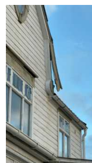
Råteskadet og løst vindsibord mot sør.
