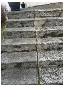
Manglende rekkverk på utvendig trapp mot sør.
