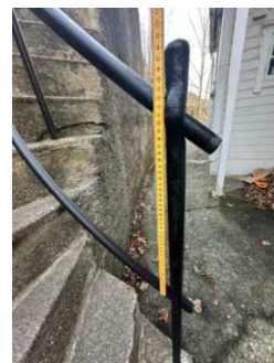
Åpninger i rekkverk mot nord er målt til å være 40cm
