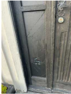
Sidefelt på inngangsdør til kjeller er knust.
