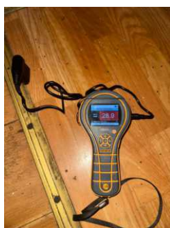
Fuktmåling med pigg i etasjeskille ved kjøkkeninnredning i 2.etasje. Måleresultat 28,9vekt%
