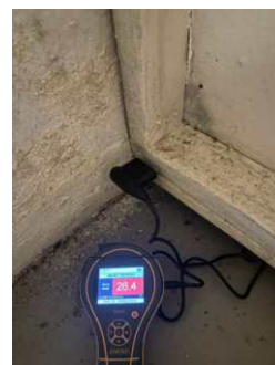
Fuktmåling med pigg ved innforet vegg på bod. Målerresultat 26,4 vekt%
