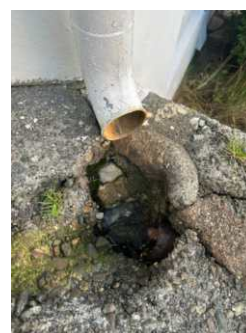
Vann fra taknedløp er ført ut ved grunnmur
