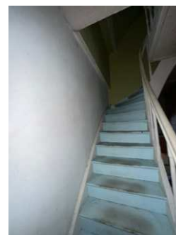
Manglende håndløper på vegg i trapp.
