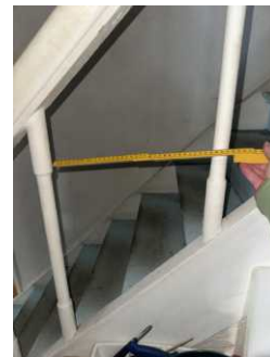
Åpninger i rekkverk er målt til å være 35cm.
