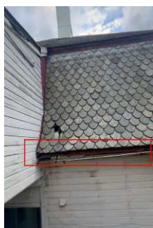
Takrenne mot nord med store deformasjoner
