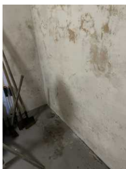
Situasjonsbilde betong gulv og vegg med saltutslag og avskalling av maling.
