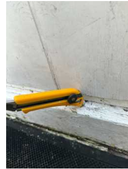
Råteskader i nedre del av inngangsdør til 1.etasje.
