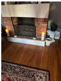
Manglende ildfast plate foran ildsted i kjeller
