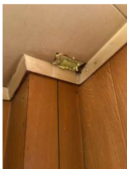
Naturlig ventileringsventil er tettet med byggsaum.
