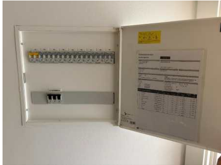
Sikringskap plassert i entre.
