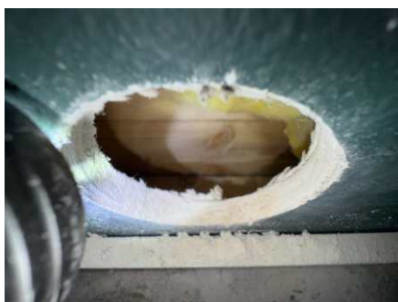
Hulltaking i tilstøtende soverom
