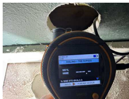
Hulltaking i tilstøtende soverom
