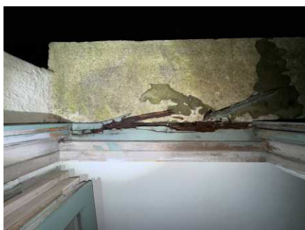
Vinduet har råteskade utvendig
