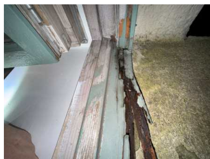
Vinduet har råteskade utvendig
