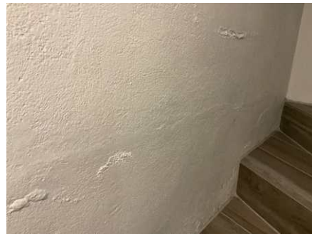
Synlig saltutslag på vegg i kjeller
