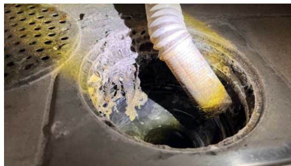
sluk under kabinett.
