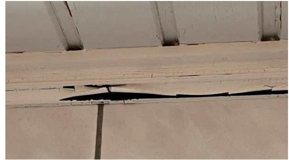
fuktskade på list
