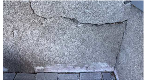
sprekk, trapp inngangsparti
