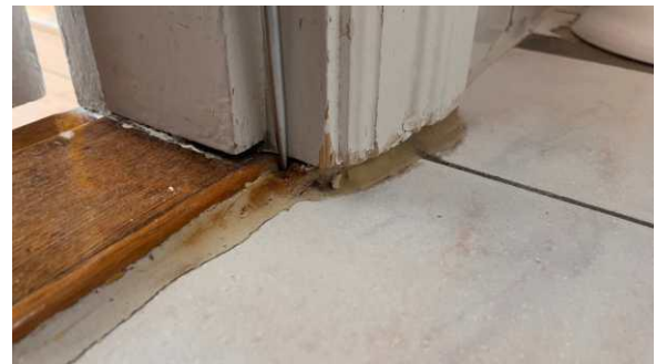
svak løsning ved dør
