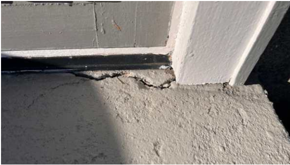
sprekk trapp, kjeller
